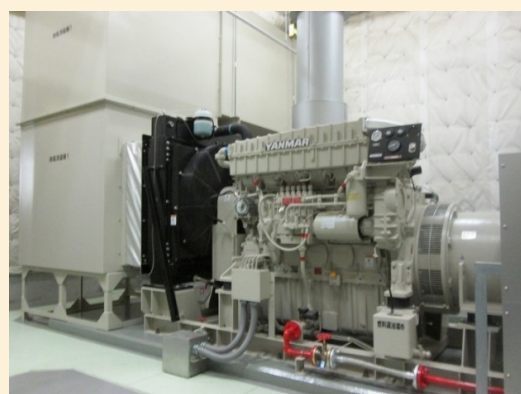
新しい非常用発電機
