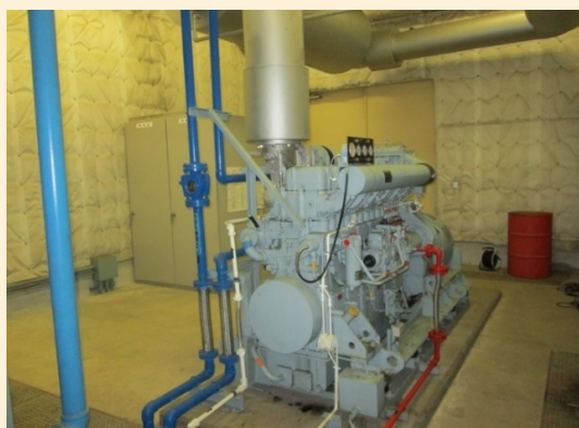
更新前の非常用発電機(昭和61年設置)
